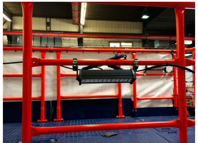
EDV-NR. 110599, Beleuchtung Standfläche Arbeitsbühne
