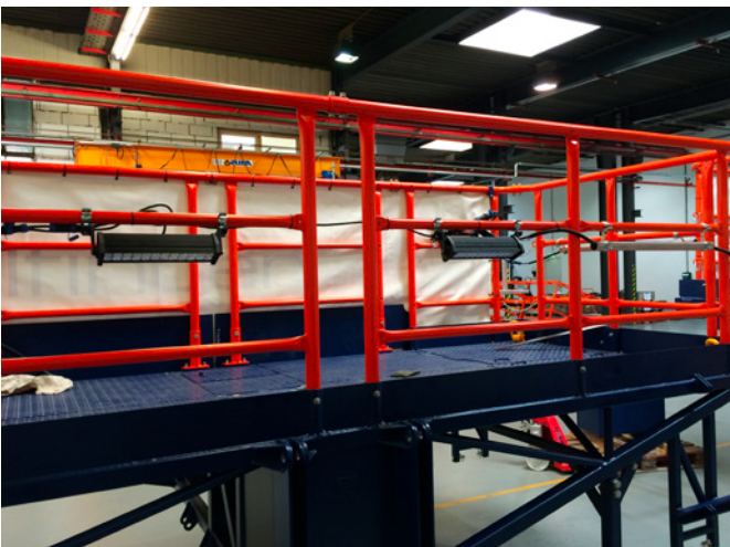
EDV-NR. 110599, Umfeldbeleuchtung Arbeitsbühne
